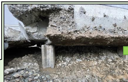
ポーチ階段の崩壊
