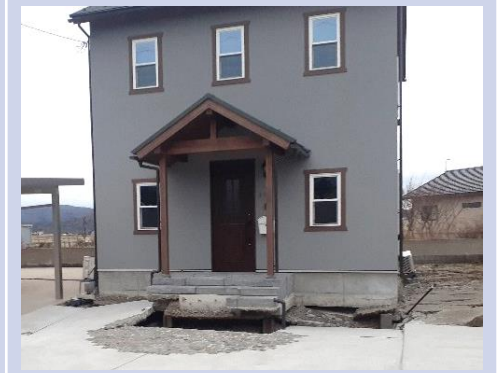
液状化被害 (松ヶ下町)
