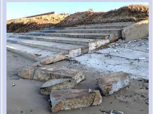
海岸被害 (釜屋町)
