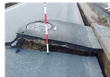
液状化により浮上した マンホール
