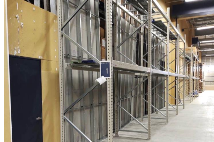
流通センター内壁の剥落(中央町地内)
