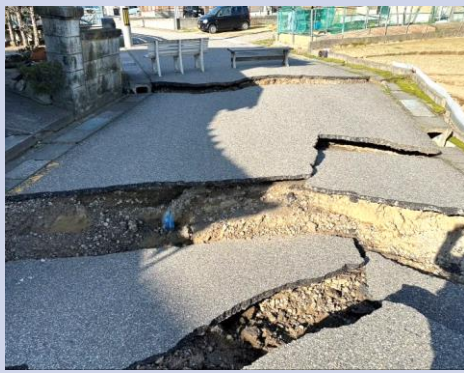
道路被害 (大川町)
