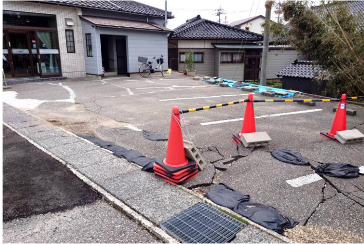
液状化により破損した理髪店駐車場(島出町地内)
