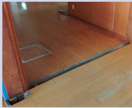
公共施設被害 (余喜保育所ホール)
