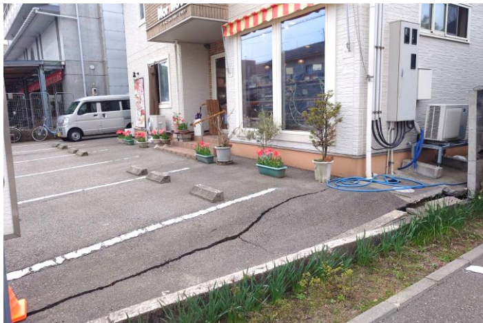
沈下したパン屋の駐車場(中央町地内)
