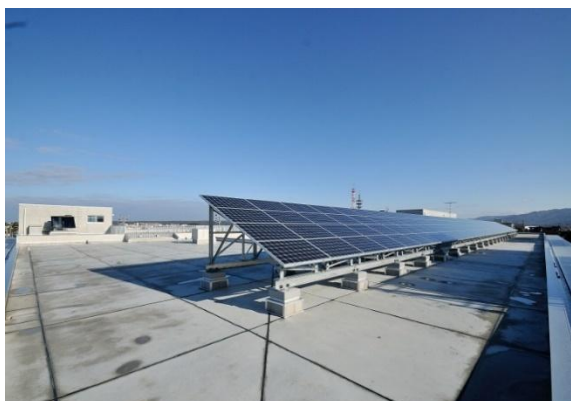
羽咋中学校の太陽光パネル
