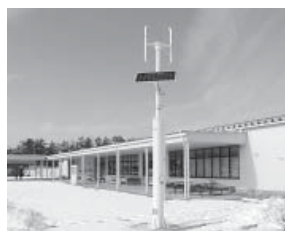
道の駅のと千里浜に設置さ れたハイブリッド街路灯
