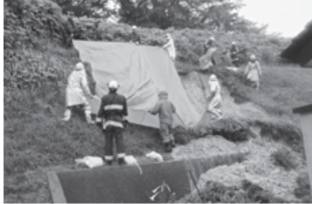
土砂崩れの応急処置（飯山町）（8月23日）
