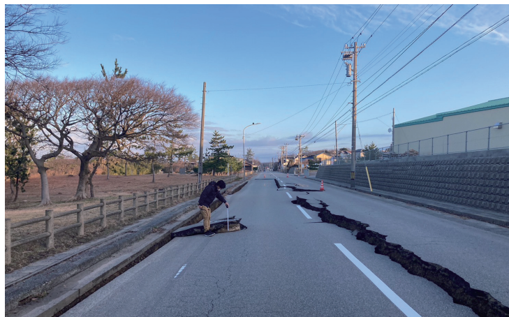
液状化による道路の地割れ（能登半島地震・千里浜町）
