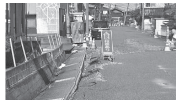
側方流動等により、ゆがんだ道路
