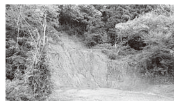
飯山町地内がけ崩れ
