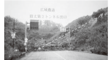
眉丈第2トンネル出口の法面崩落現場
