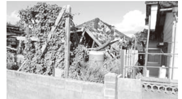
倒壊した空家 (川原町)
