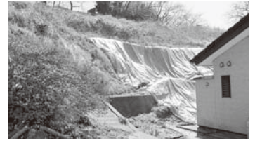
大雨被害の傷跡
